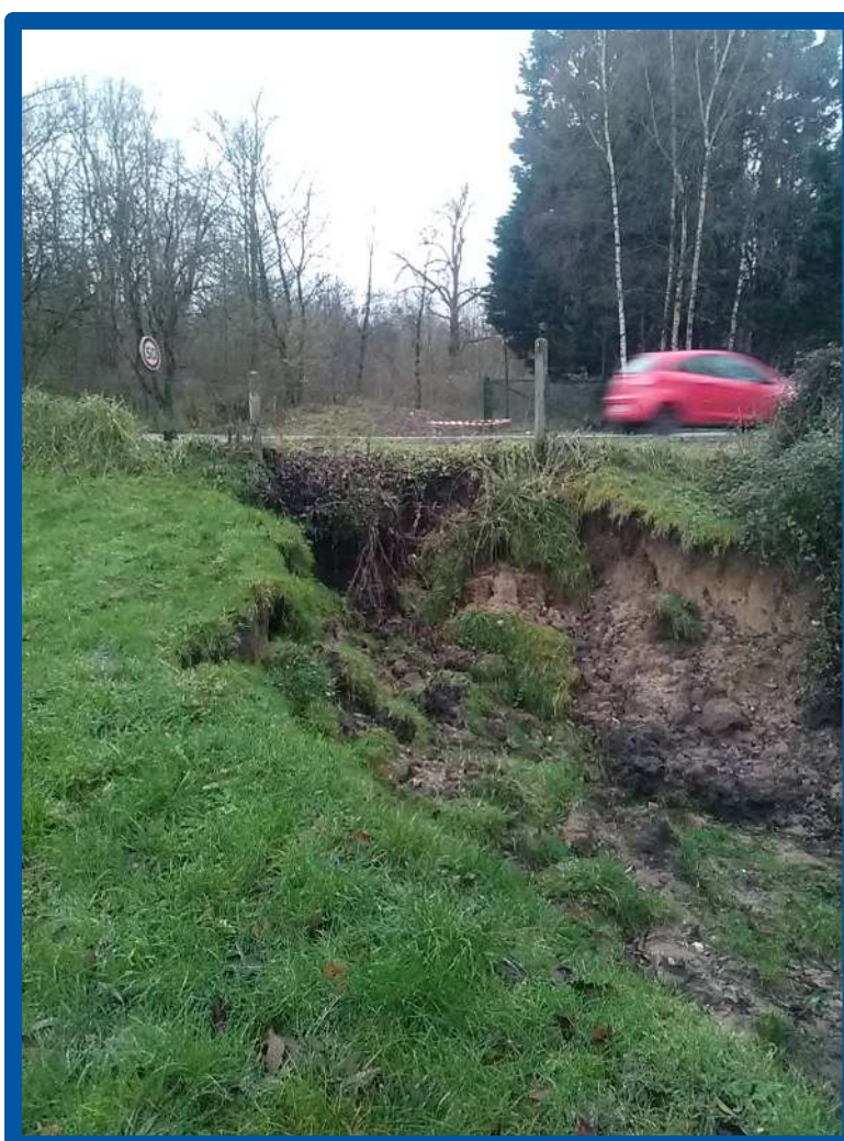
Glissement de terrains
